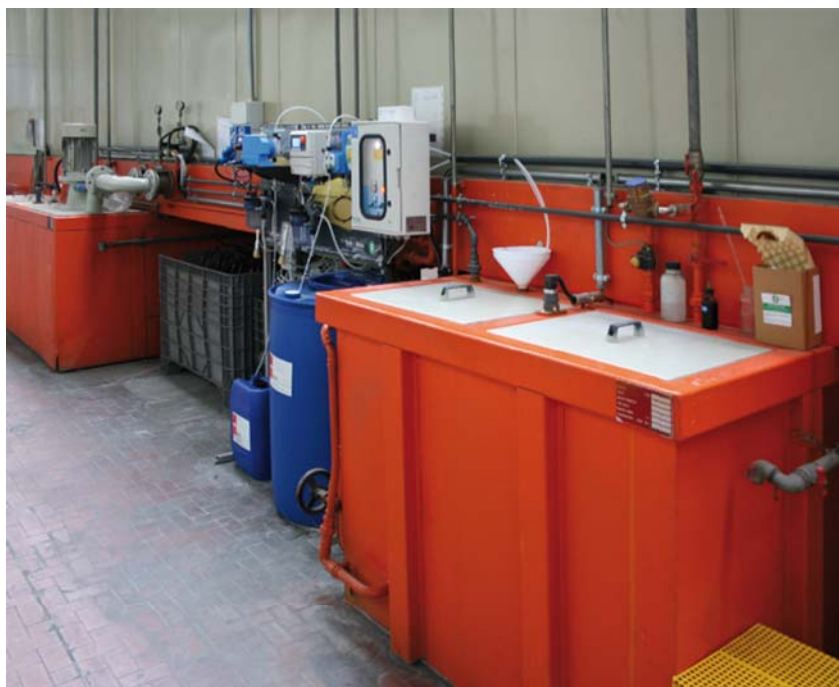
8 - L'impianto di osmosi inversa per la formazione di acqua demineralizzata. L'installation d'osmose inversée pour la formation d'eau déminéralisée.
